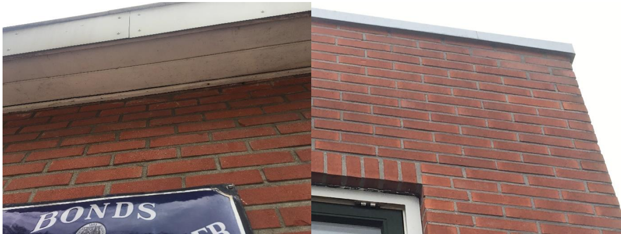
Foto links; de betimmering van het dak overstek sluit naadloos aan op de buitengevels. Foto rechts; de metalen daklijsten sluiten naadloos aan op de buitengevels. .
