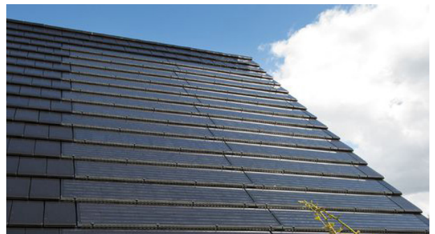
Het zorgvuldig inpassen van zonnecollectoren in het dakvlak, gecombineerd met de antracieten kleur van de dakpannen zorgt ervoor dat deze niet nadrukkelijk zichtbaar zijn.
