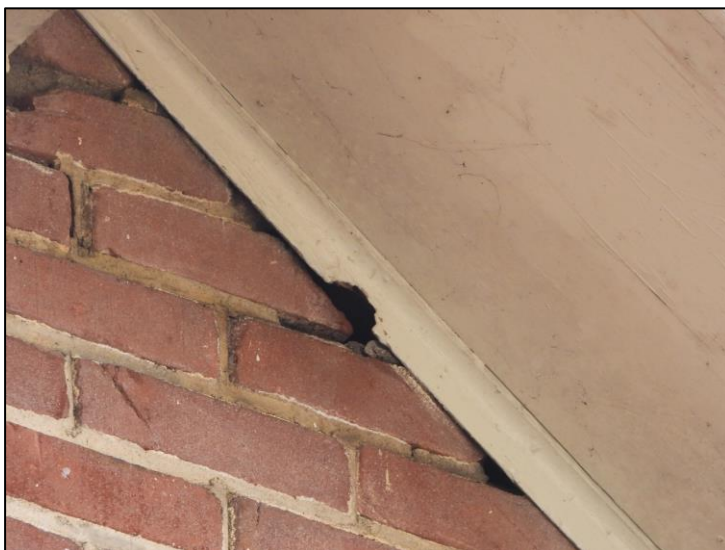
Kieren tussen de buitengevel en de dak overstek kunnen als invlieg opening gebruikt worden door gierzwaluwen. Gierzwaluwen kunnen hier een nestplaats hebben.
