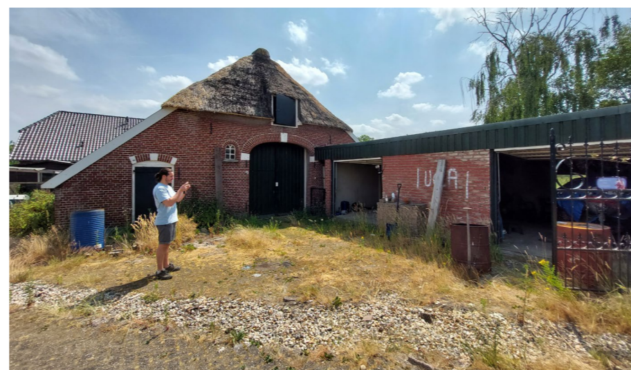
De oude schuur met bijgebouwde garages in slechte staat
