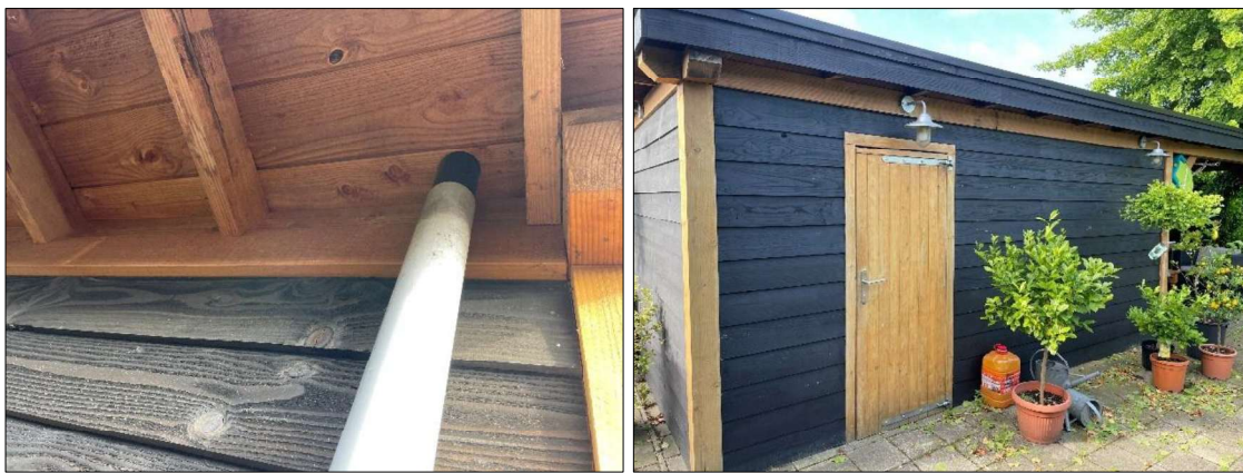
Foto's waarop te zien is dat er bij de overkapping en bijgebouw geen geschikte plekken voor vleermuizen zijn om de binnenzijde van het gebouw te bereiken.
